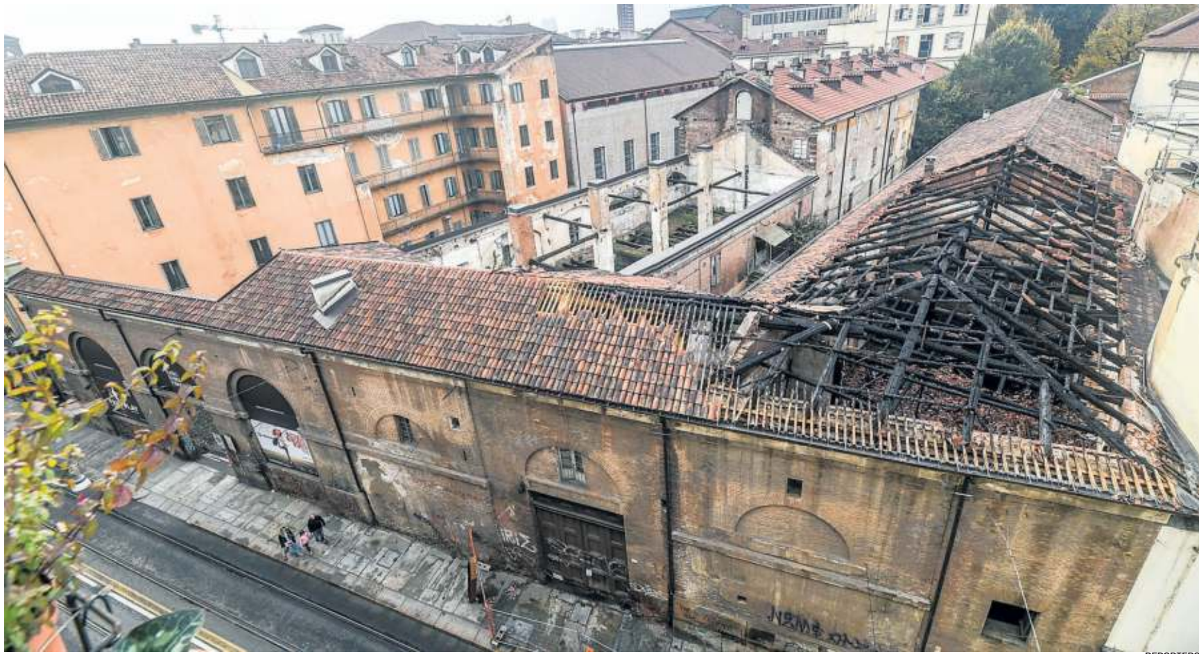
I danni provocati dall'ultimo incendio, nell'ottobre 2019
